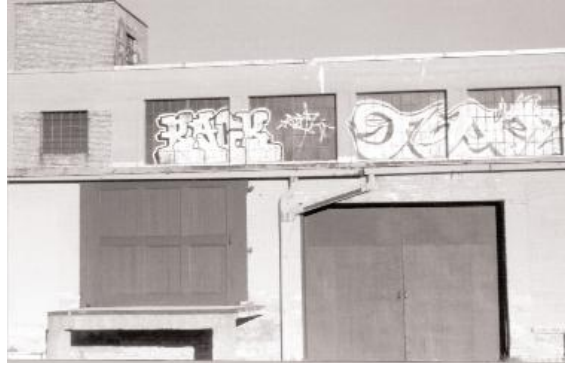
Frequentemente os graffiti aparecem em locais de difícil acesso, contudo altamente visíveis, como os que foram feitos na parte superior das janelas deste armazém.
